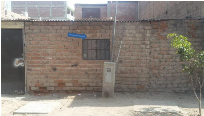
Figura No.04.- Muro de ladrillo sin columna – ventana sin viga
