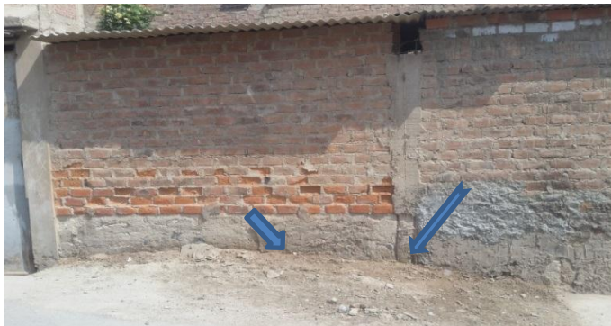
Figura No.02.- Muro de ladrillo carcomido- Fierro de columna oxidado
