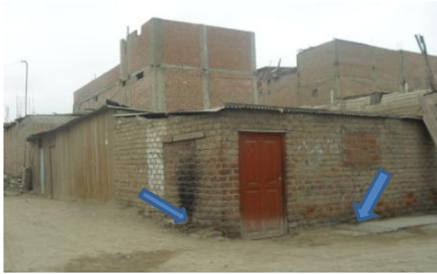
Figura No.03.- Muro de ladrillo sin sobre cimiento
