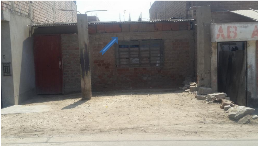
Figura No.06.- Fierro de la viga visible y con oxido.
