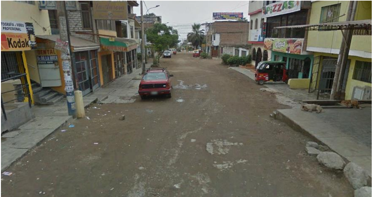
Fotografía 1: Calle 06, se observa la existencia de veredas construidas precariamente, y la falta de pavimento.
